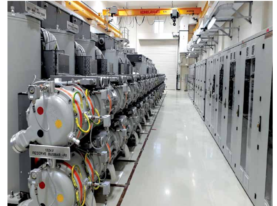
132 kV Al Daayen-2 - GIS
