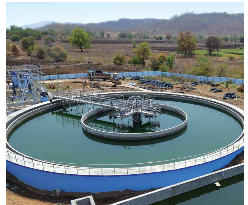
39 m Dia. Clariflocculator
