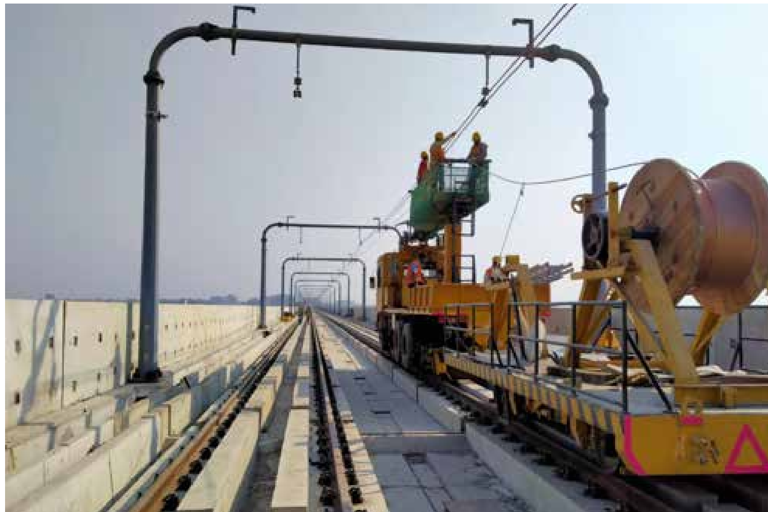
Viaduct OCS wiring
